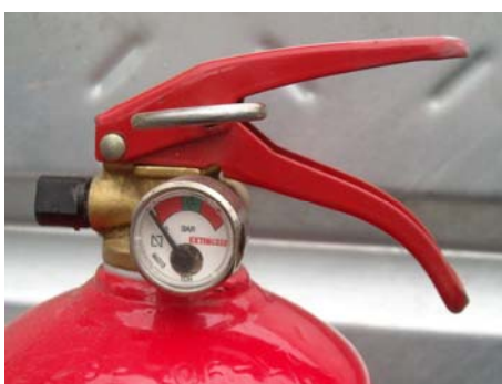
Extintor sin presión
