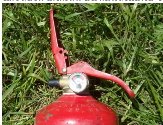
Extintor sin anilla de seguridad
